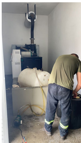
Manutenção Preventiva dos Grupos Geradores de Energia da Subestação
