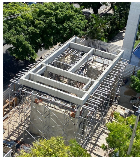
Laje da Unidade de Controle
