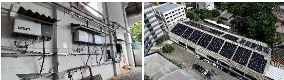
IMAGENS DA EXECUÇÃO FÍSICA DO SISTEMA DE ENERGIA SOLAR CONCLUÍDO
