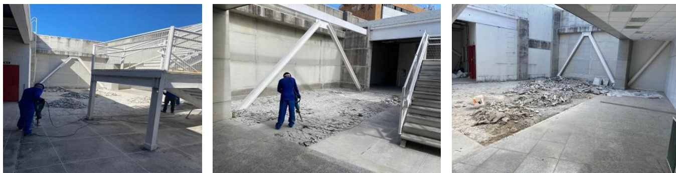
IMAGENS ILUSTRATIVAS DO INÍCIO DA REFORMA DO 8º ANDAR DO EDIFÍCIO 5 DE OUTUBRO
