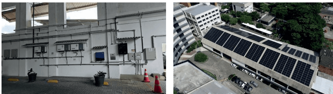
IMAGENS DO SISTEMA DE ENERGIA SOLAR INSTALADO E EM FUNCIONAMENTO
