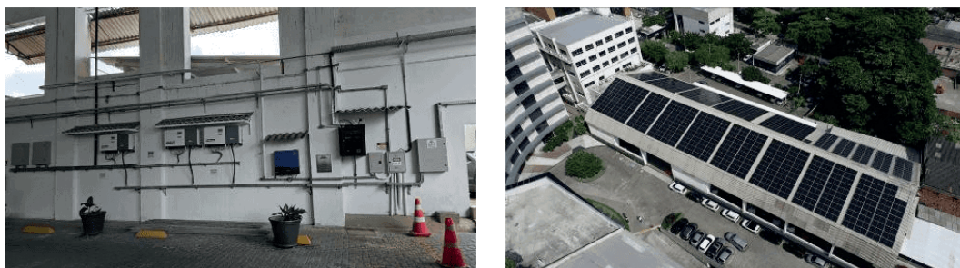
IMAGENS DO SISTEMA DE ENERGIA SOLAR INSTALADO E EM FUNCIONAMENTO
