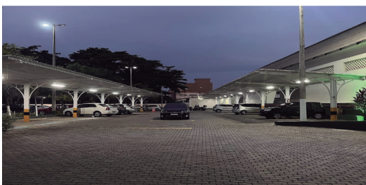
Foto 08 – Otimização das Luminárias
