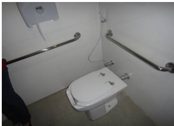
Figura 03 – Banheiro com papeleiras e barras de apoio instaladas perto do sanitário.
