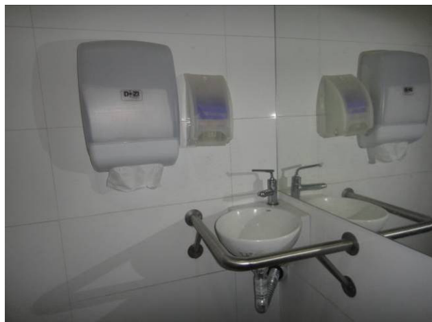
Figura 02 – Banheiro com papeleiras e barras de apoio instaladas perto da pia.
