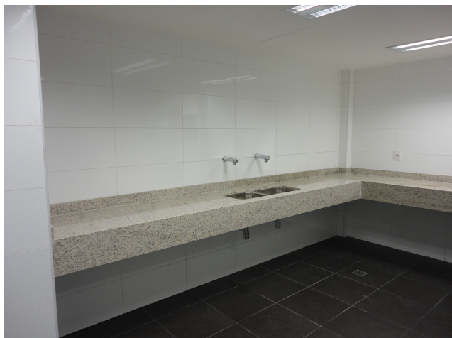
Foto 16 – Copa – faltam armários, prateleiras para guarda de material e utensílios
