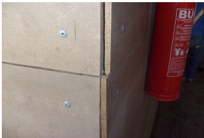
Foto 04 – painéis Viroc mal fixados, frouxos e riscados
