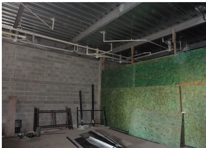
Foto 21 – Área destinada ao refeitório da SESPORTE sem acabamento algum
