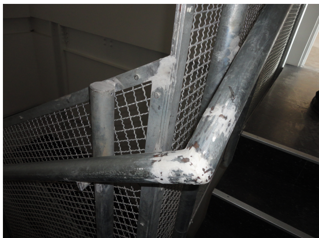
Foto 20 – Escada de emergência sem acabamento / pintura
