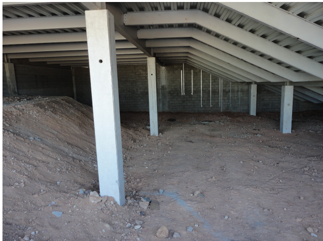
Foto 10 – área sob a rampa de acesso, sem acabamento / fechamento
