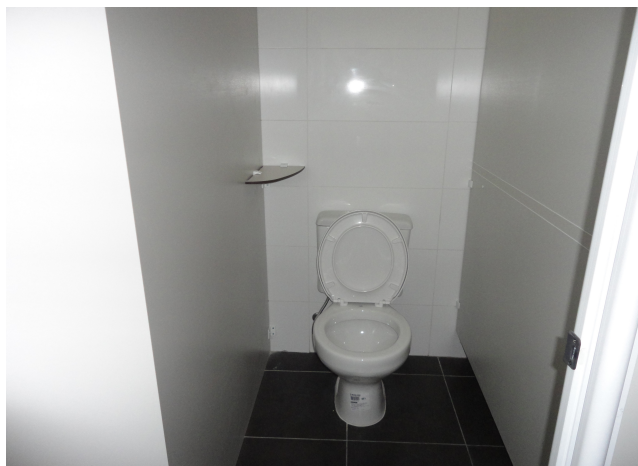
Foto 15 – banheiros sem instalação de duchas e acessórios
