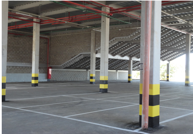
Foto 07 – sistema de sprinklers sem teste hidrostático / funcionamento
