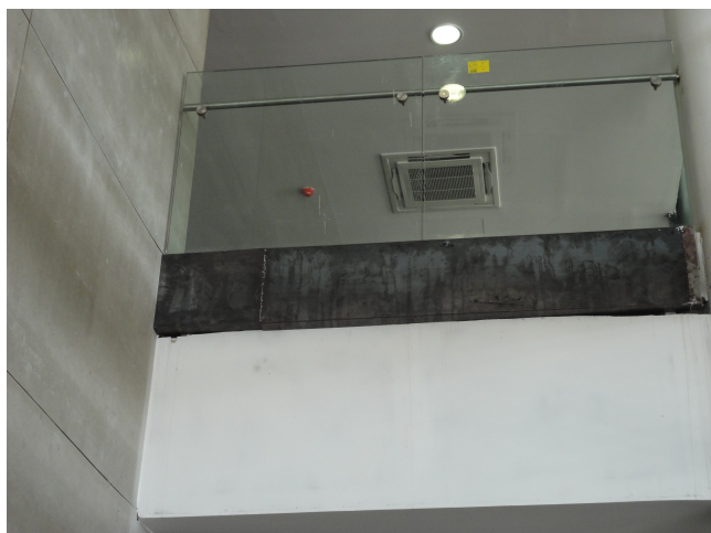
Foto 12 – viga metálica sem pintura / acabamento
