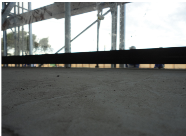
Foto 13 – falta de acabamento entre o peitoril e a estrutura metálica da pele de vidro
