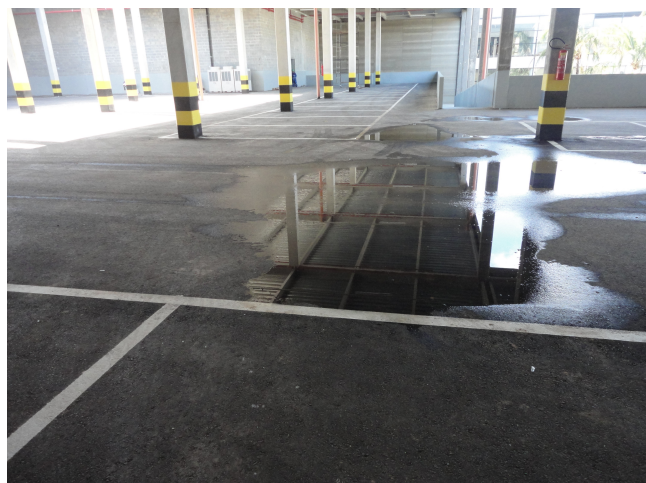
Foto 03 – Ausência de canaletas e grelhas para drenagem
