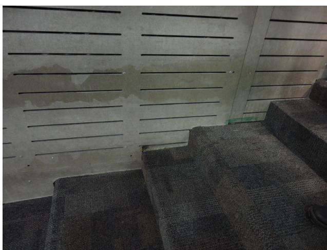
Foto 17 – Falta de acabamento (rodapés) nos painéis Viroc
