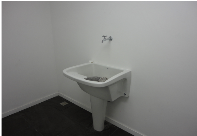
Foto 19 – Paredes próximas a tanque de serviço sem revestimento cerâmico
