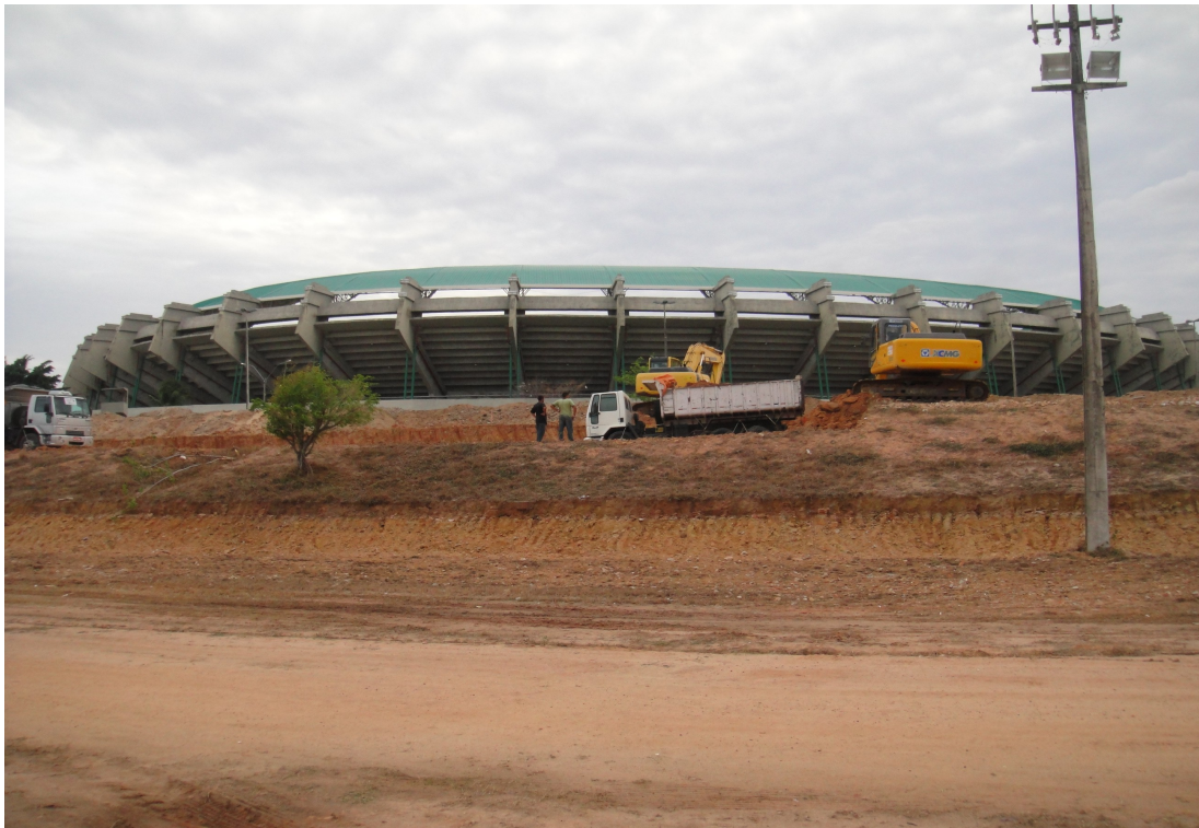
Figura 06 – Início da ETAPA 01 que compreende o edifício-sede da Secretaria de Esportes (SESPORTE) e o estacionamento 01
