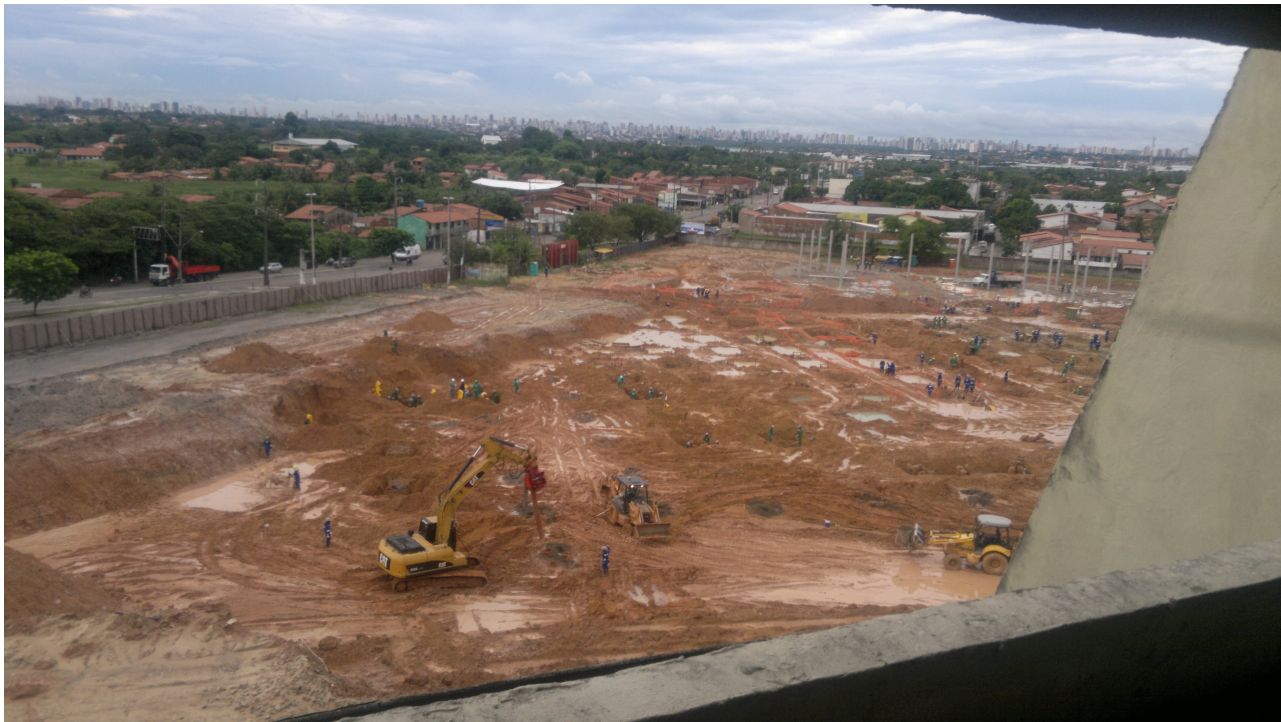
Figura 07 – ETAPA 01 – Vista do local da secretaria e 1ª etapa do estacionamento. Observar detalhe das estacas de reforço de solo sendo produzidas “in loco” (data: 13/04/2011)
