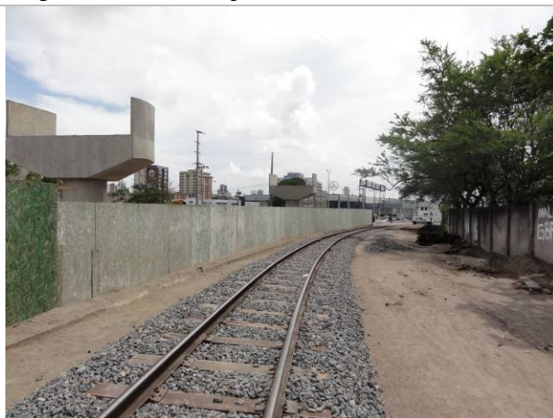
Foto 3 – Requalificação da Linha de Cargas na proximidade do cruzamento com a Av. Aguanambi.
