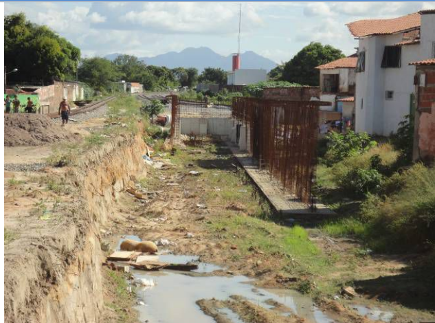
Foto 2 - Muro de arrimo inacabado.
