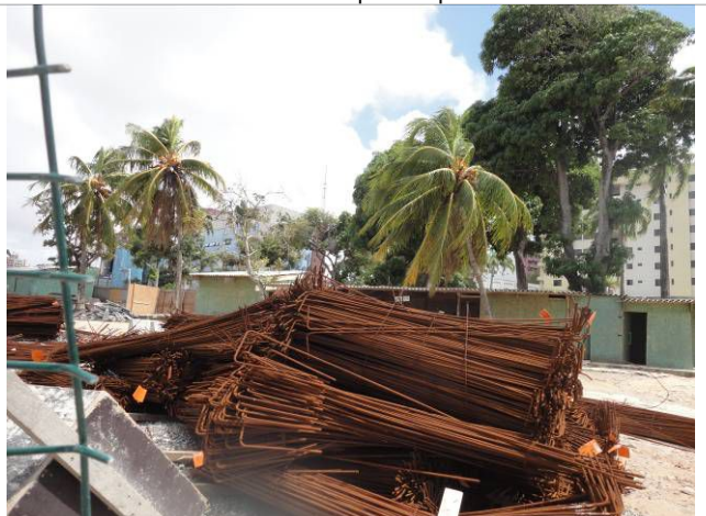
Foto 12 - Ferro posto em canteiros de obra desativado.
