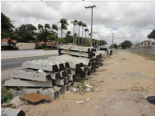
Foto 11 - Dormentes de concreto posto em obra paralisada.
